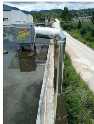
已安装油烟净化器
